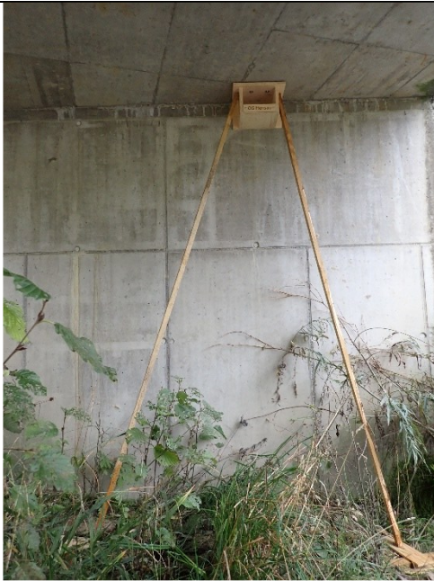
Stippering mit zwei Stützen zum Kleben der Kästen die seitlich an die Brückenwand angelehnt werden.
